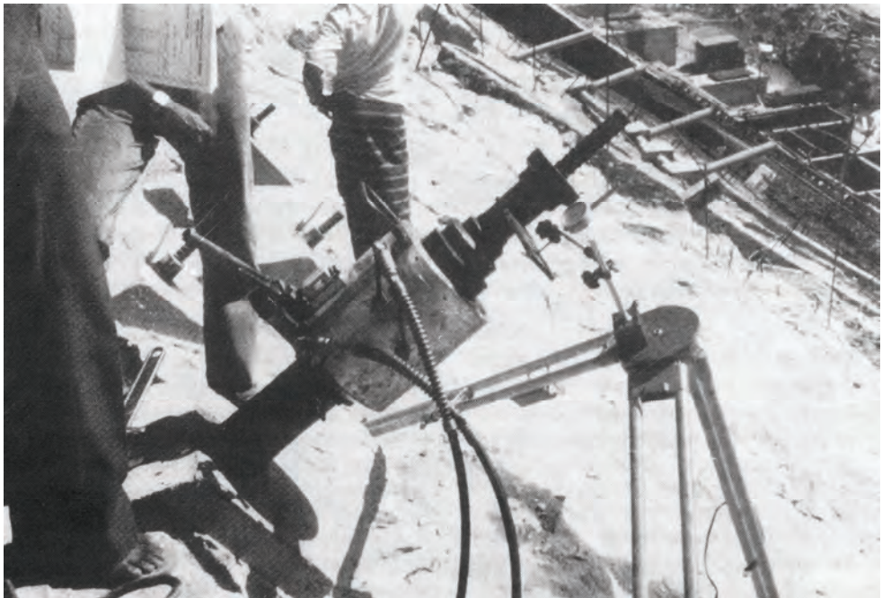
Εφαρμογή συστήματος προεντεταμένων αγκυρίων για την αύξηση της ευστάθειας θεμελίωσης σε πρανές (Franklin, Dusseault, 1994).
