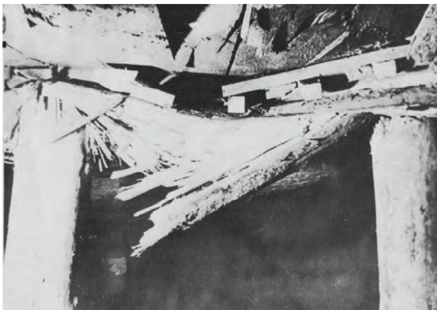
Αστοχία της προσωρινής, ξύλινης υποστήριξης. Η υποστήριξη υποχωρεί ενώ ταυτόχρονα τα φορτία μειώνονται σε βαθμό που η αδύναμη πλέον υποστήριξη είναι σε θέση να τα παραλάβει. Πάνω: (Feder, Olsacher, 1978). Κάτω: (Rabcewicz, Pacher, 1976).
